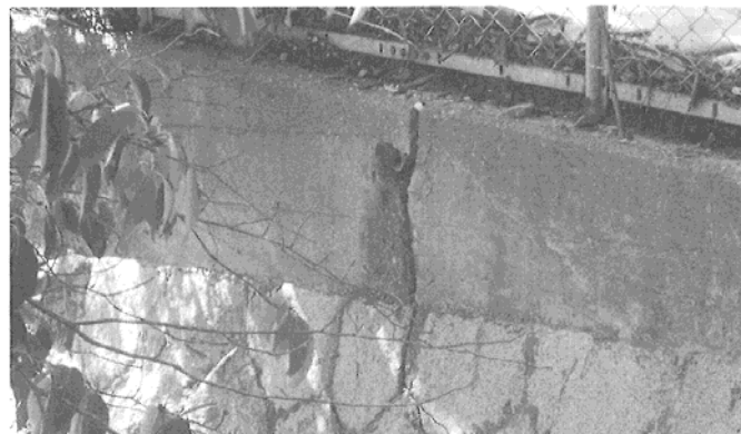
▲山桜の根が護岸を圧迫し、ひび割れたコンクリートの堤防
